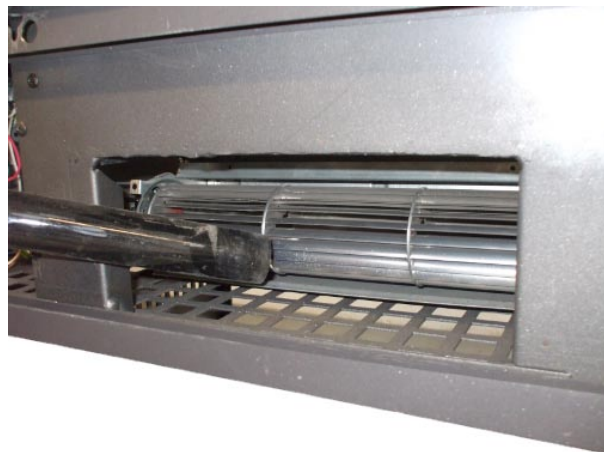
Fig. 40 - Nettoyage de le ventilateur ambiant
